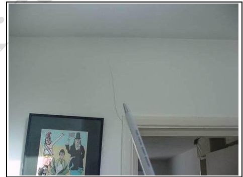
Crack above door
