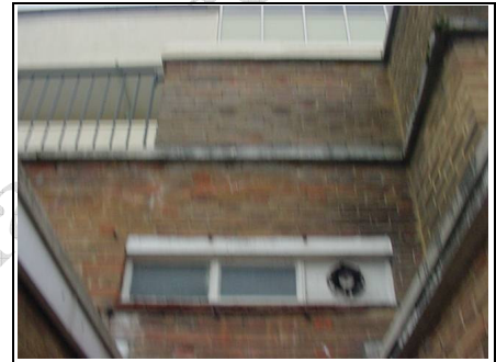
Broken extract fan
