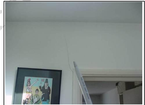
Crack above door
